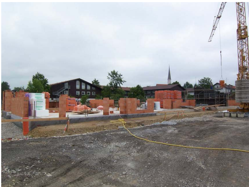
Juni 2006: Die Bodenplatte ist fertig, die ersten Mauern wachsen in die Höhe.
