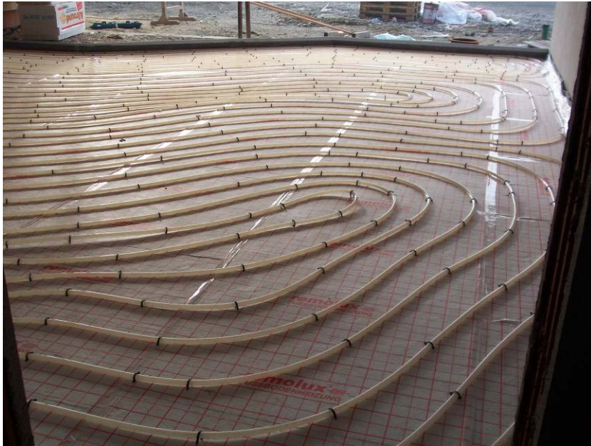
Oktober 2007 wie eine unendlich lange Schlange: Die Rohre der Fussbodenheizung
